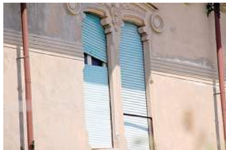
Persiane rotte sulla facciata Ovest
