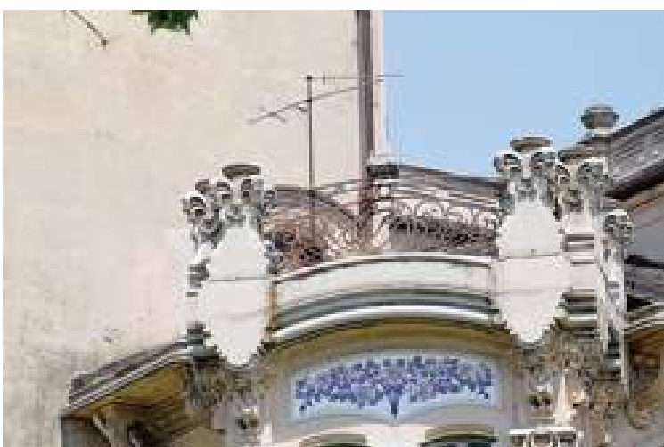
Un'altra immagine del degrado di Villa Zanelli
